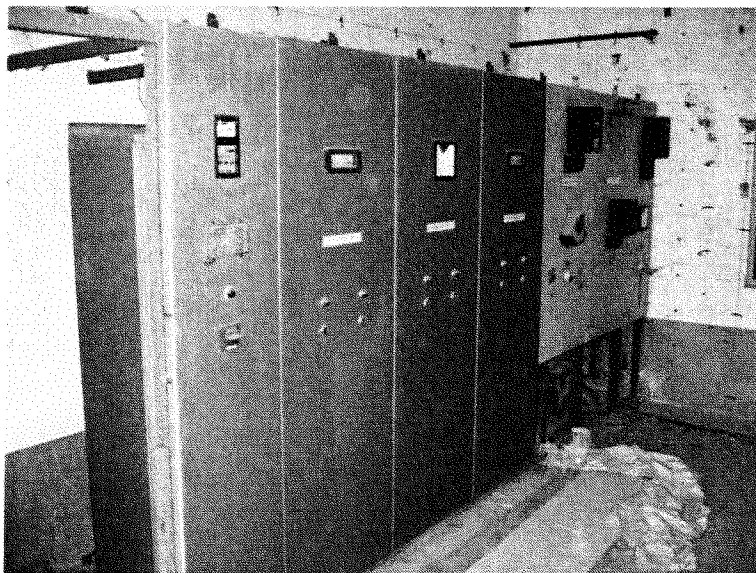
Local électrique – coté gauche
