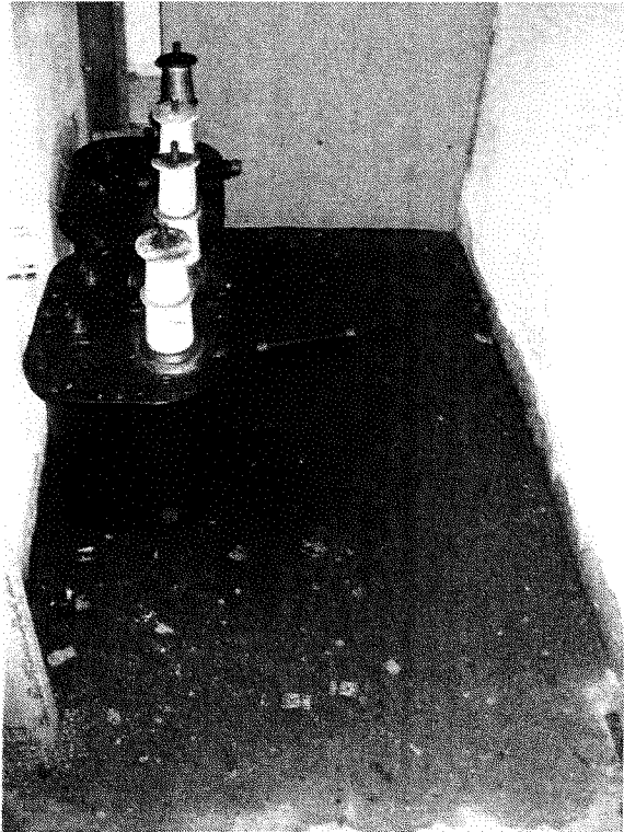
Local électrique – premier étage – vue de la dalle impactée
