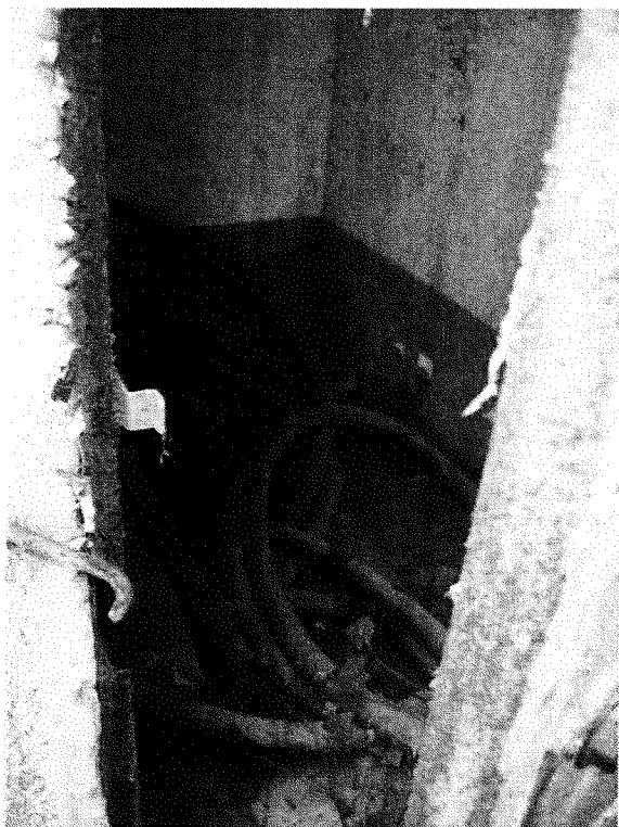
Intérieur du transformateur n° 1
